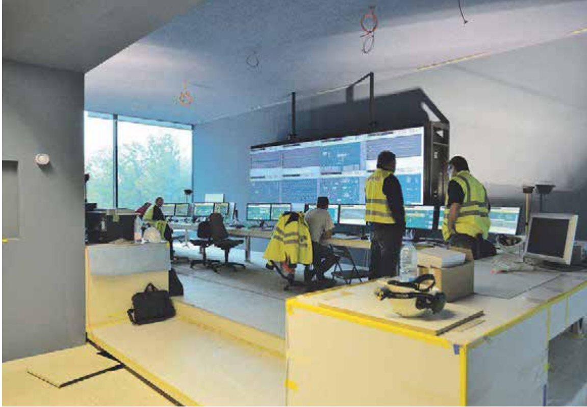
Blick in die «Kommandozentrale» der neuen Anlage.
